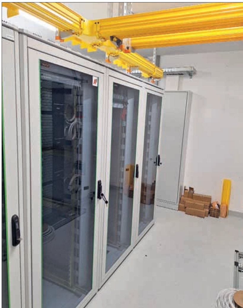
Der Detailausbau für die Glasfasertechnik in der Ortszentrale im neuen Gesundheitszentrum, in welcher alle Glasfasern in Virgen zusammenlaufen, wurde fertiggestellt. Die Ortszentrale ist somit betriebsbereit.
