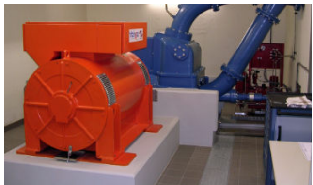
Kraftwerk Steinkasbach liefert seinen Strom
