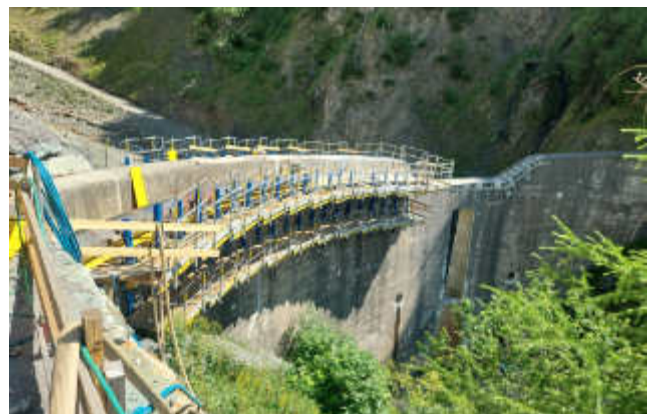
Die Betonrampe ermöglicht ein Befahren der Sperre um beispielsweise Verkläuerungen zu beseitigen.
