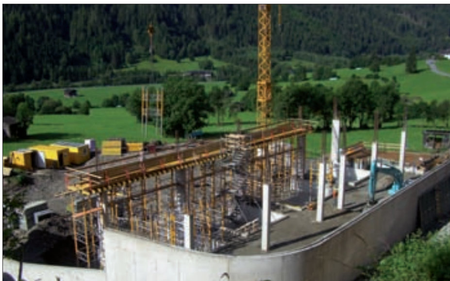
An den Unterzügen und der Decke über dem Recyclinghof wird bereits gearbeitet. Fotos: Fritzenwanger
