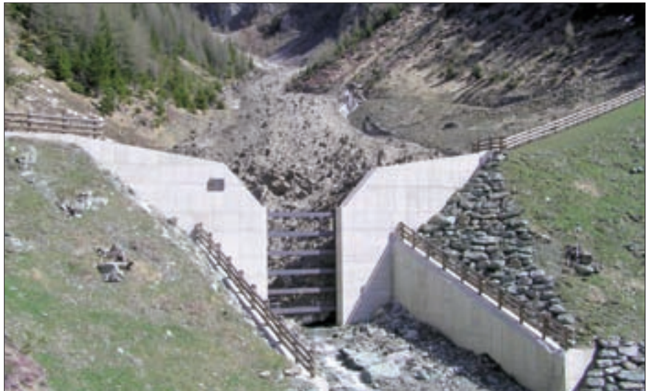
Im vergangenen Winter wurden die Geschieberückhaltesperre und der große Lawinendamm bereits durch ein Lawinenereignis auf die Probe gestellt.
