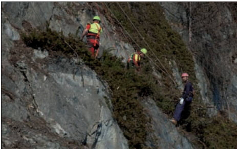
Zur Sicherung der Gemeindestraße im Bereich „unterm Palfen“ werden zurzeit Felsabräumarbeiten durchgeführt. Verkehrsteilnehmer müssen mit kurzen Wartezeiten rechnen.
