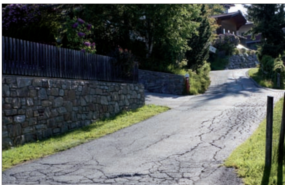
Das Befahren der Straßen in Tauperioden mit schweren Fahrzeugen führt zu erheblichen Schäden.
