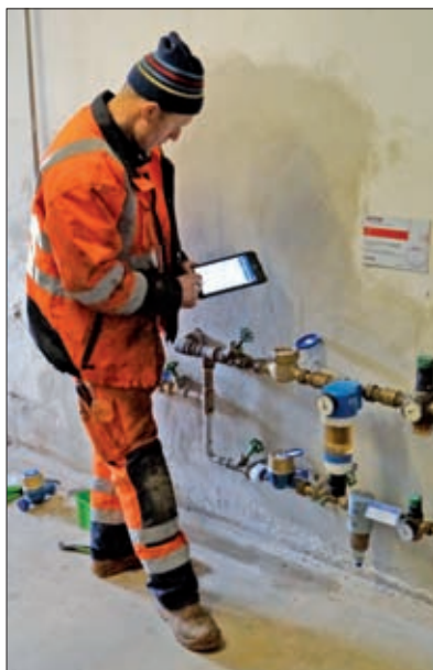
Auch der Austausch von Wasserzählern wird mittels Tablet dokumentiert.
